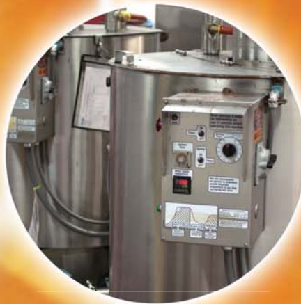
鍋爐前端預熱
